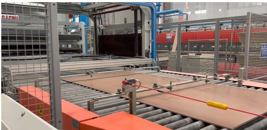
Figure 6 - lastra in entrata essiccatoio
